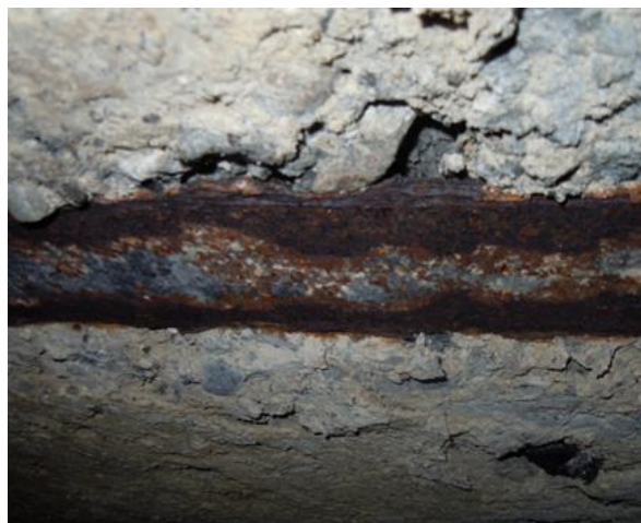
bauliche Mängel, Zivilschutz-Standort Usterstrasse
